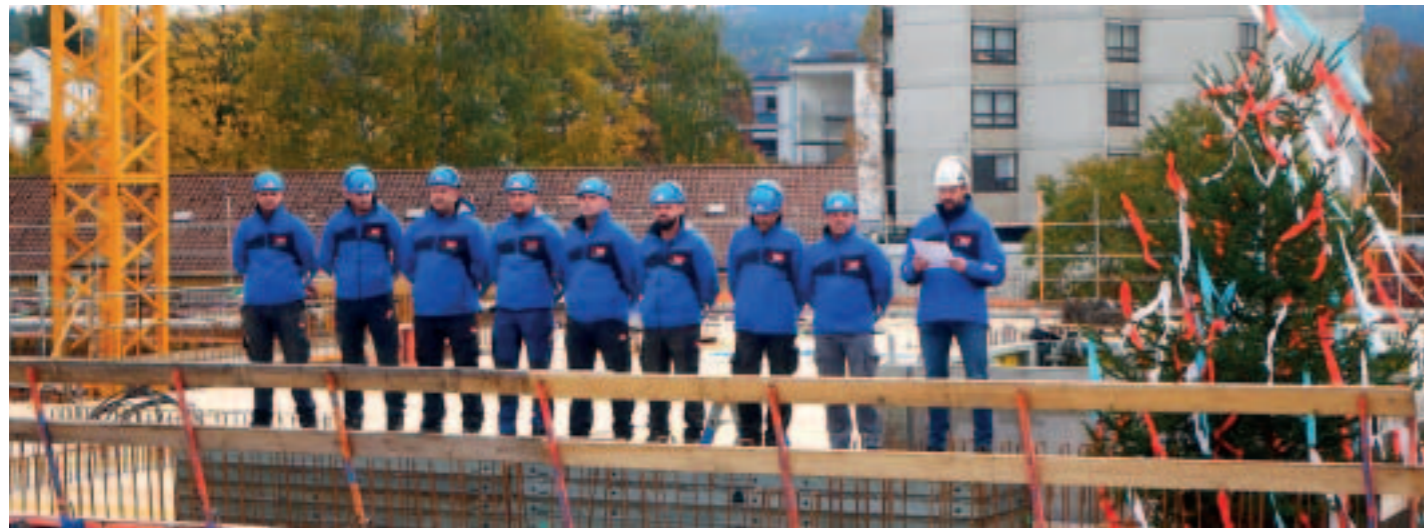
Ein großer Augenblick: Die Mannschaft der Baufirma Decker bringt auf dem Dach des Rohbaus des neuen Bettenhauses E den Richtspruch aus. Bis Juli 2027 soll das Gebäude fertig gestellt sein, der Einzug der Abteilungen Altersmedizin und Schmerztherapie ist zum Jahreswechsel 2027/28 geplant.
